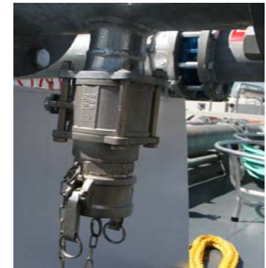
KAMLOK-Kupplung (nach Norm: EN 14 420-7 DN 50) Quelle: P. Sauter Port of Basel
